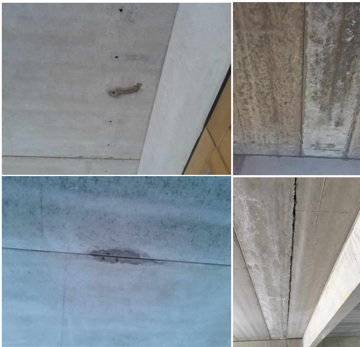
Obr. 3 – spodní líc dílců Spiroll – odvodňovací otvory, rozdíly v jednotnosti barevného tónu, protečení vody spárou, spára mezi doplňkovými šířemi
